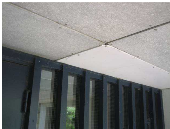
Foto 18: Prøve Asbest 7 er udtaget af hvid loftsloftsplade fra søjlegangen under bygningen ved opgang 23
