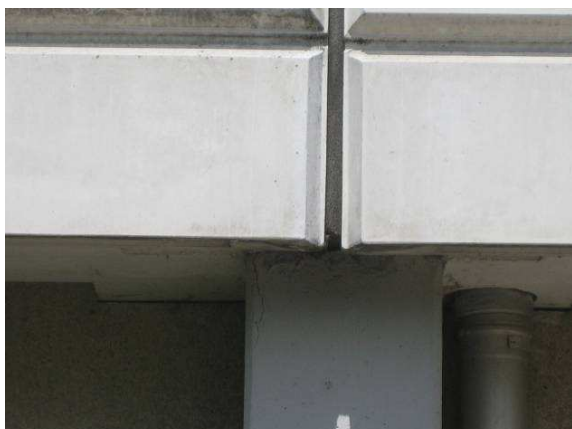
Foto 17: Prøve PCB 3 er udtaget som samleprøve af 5 delprøver af facadefuger nær terræn på sydsiden ved opgang 13, 25, 29, 37 og 41
