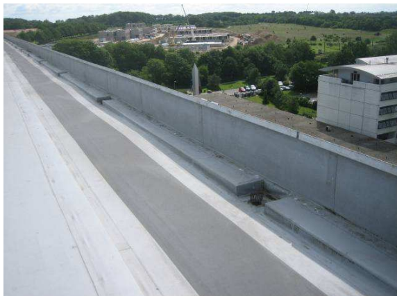
Foto 1: Prøve PCB 1 er udtaget af fuge langs kant af taget ved sydfacaden ml. opgang 25-29
