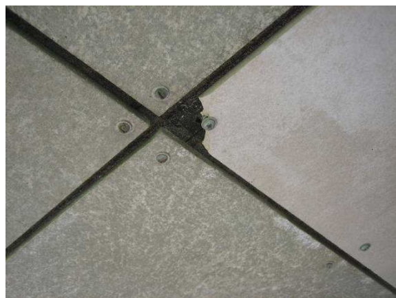
Foto 12: Prøve Asbest 5 af lysegrå loftsplade fra søjlegangen under bygning ved opgang 27
