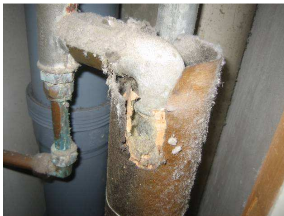
Foto 4: Prøve Asbest 1 er udtaget fra isolering om varmtvandsrør
