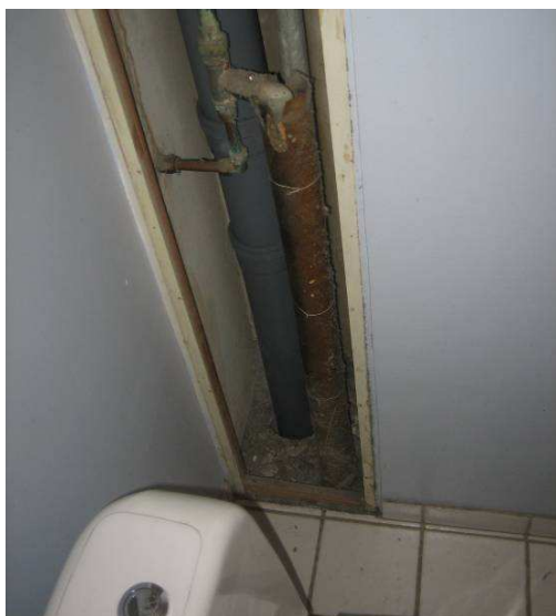
Foto 3: Prøve Asbest 1 er udtaget fra isolering om vandrør ved toilet i lejlighed 27, 7.tv
