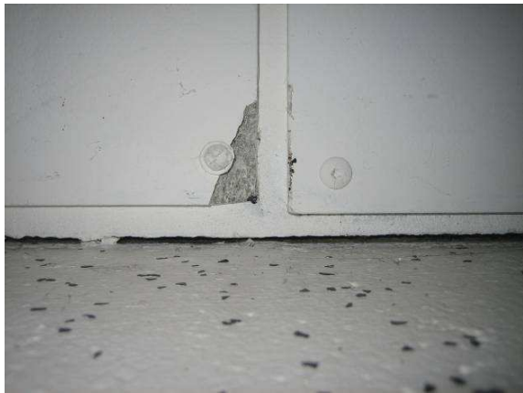
Foto 9: Prøve Asbest 3 er udtaget af de hvidmalede loftsplader indendørs i viadukt under bygning ved opgang 27
