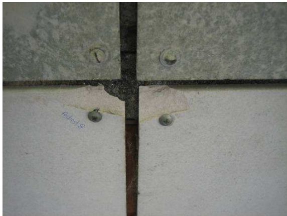
Foto 19: Prøve Asbest 8 er udtaget af hvidgrå loftsplade fra søjlegangen under bygningen ved opgang 27
