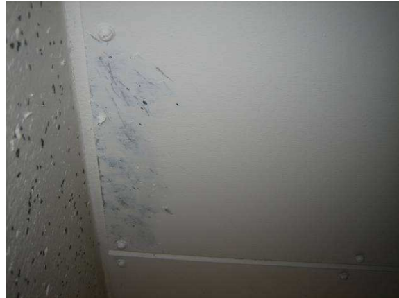
Foto 20: Prøve Bly 3 er udtaget fra loftsmaling indendørs i viadukt under bygningen ved opgang 29
