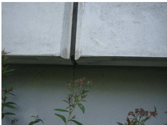
Foto 15: Prøve PCB 2 er udtaget som samleprøve af 5 delprøver af facadefuger ved terræn på nordsiden ved opgang 11, 19, 27, 29 og 35
